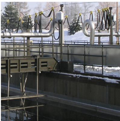
Hauptversorgung eines Längsräumers in einem Klärwerk
