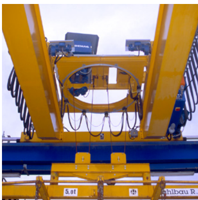
Versorgung einer Drehkatze an einem EOT-Kran
