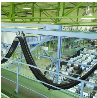
Energie- und Datenübertragung an einem Stahlwerkskran
