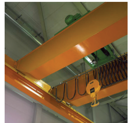
Katzerversorgung an einem Brückenkran
